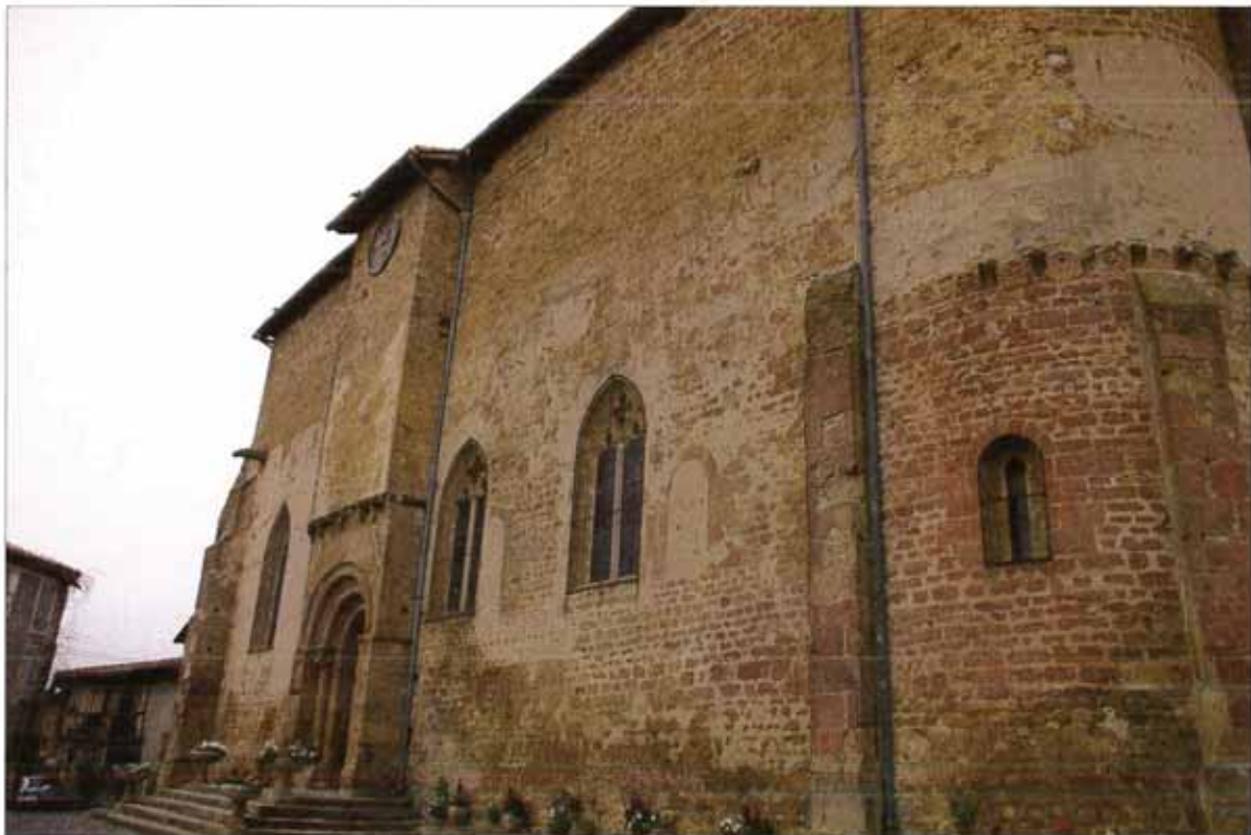
FIG. 4. AIGNAN, ÉGLISE SAINT-LAURENT, vue de l'église depuis l'angle sud-est. Cliché C. Balagna.
